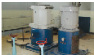
Les pompes du captage d'eau potable de Corbas - Romanettes
