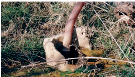
Tête d'un forage mal protégé
