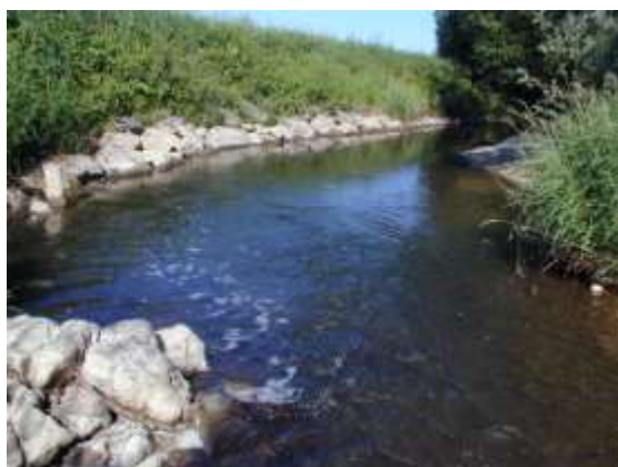
Figure 11 : Enrochement de berge
