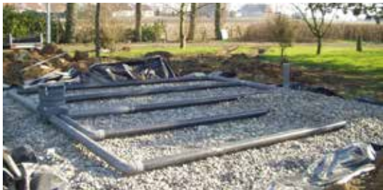
Installation d'assainissement non collectif - AEAP
