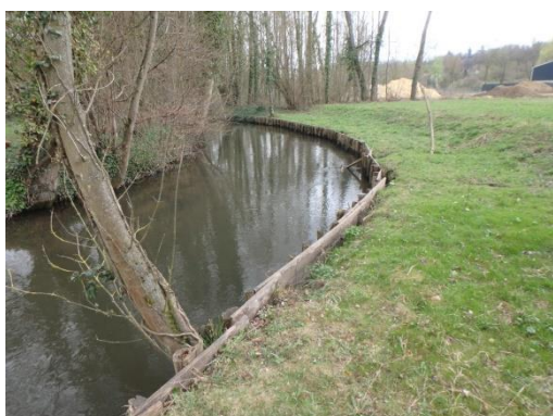
Photo 19: Tunage en bois obsolète
