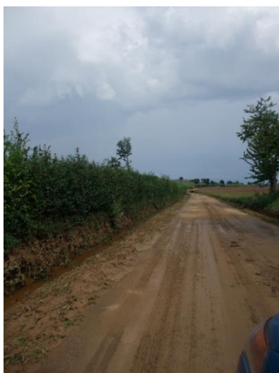
Coulée boueuse sur la route du May à Jallais
