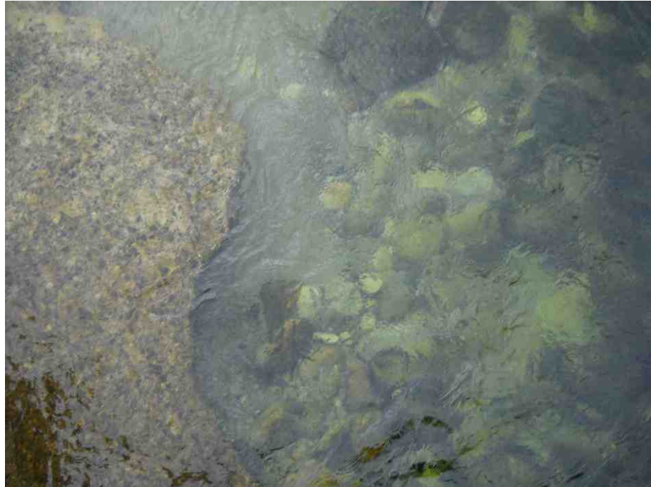
Figure 23 : Photo de l'affouillement d'une pile de la passerelle (POYRY, 2011)
