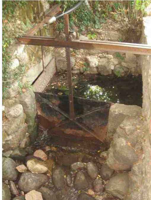
Figure 7 : Photo Vannes de décharge (POYRY, 2012)
