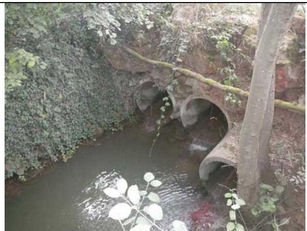
Photo 91 : Passage busé infranchissable pour les espèces aquatiques (ISE5)
