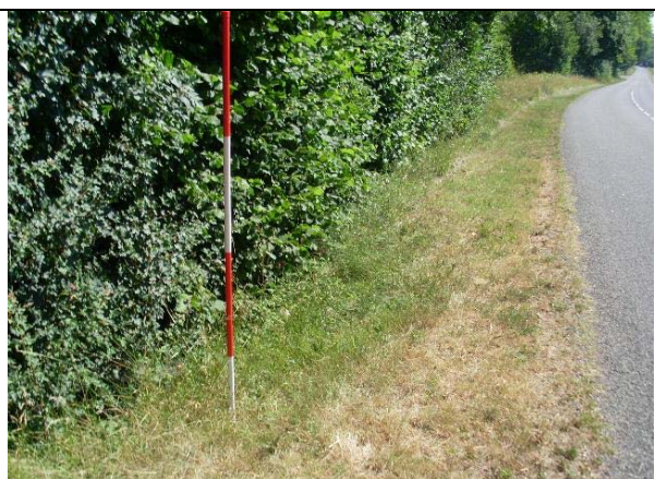
Photo 119 : dépression le long de la route D55 correspondant à l'emplacement d'une encoche au
