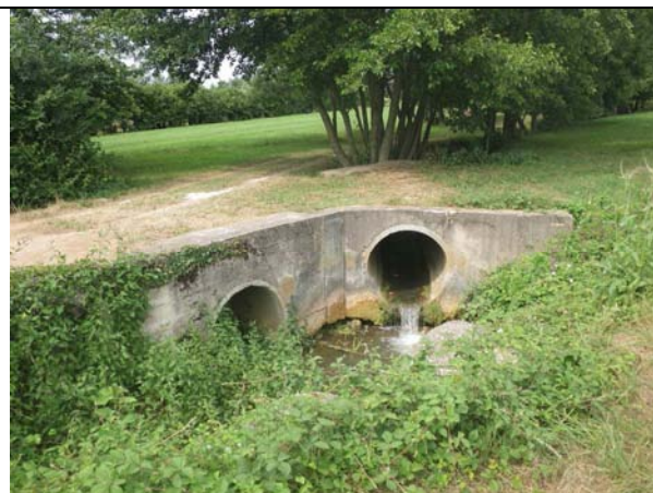
Photo 87 : passage busé sur le ruisseau de l'Isérable (ISE1), incompatible avec la continuité écologique.
