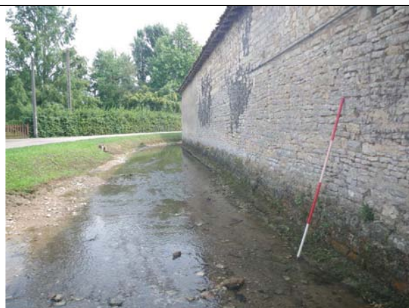
Photo 133 : ruisseau surcalibré dans la traversée de Mercey (GRA2)
