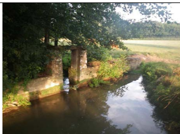
Photo 120 : Ouvrage détruit destiné à l'irrigation des prairies en rive droite (BOU5)
