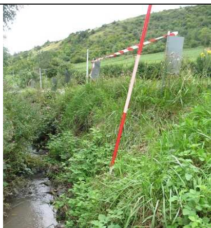
Photo 99 : Talus de la route en effondrement. Protection à réaliser nécessaire (PMO2b)
