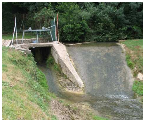
Photo 5 : ouvrage partiteur de la pisciculture du moulin Mutin (NAT09)
