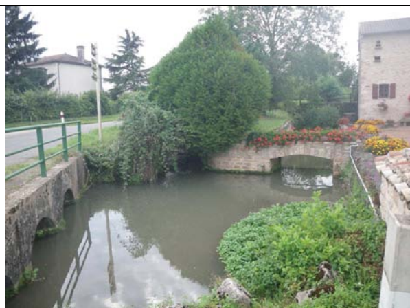
Photo 135 : pont de la D410 sous dimensionné (à droite de la photographie) (GRA4)
