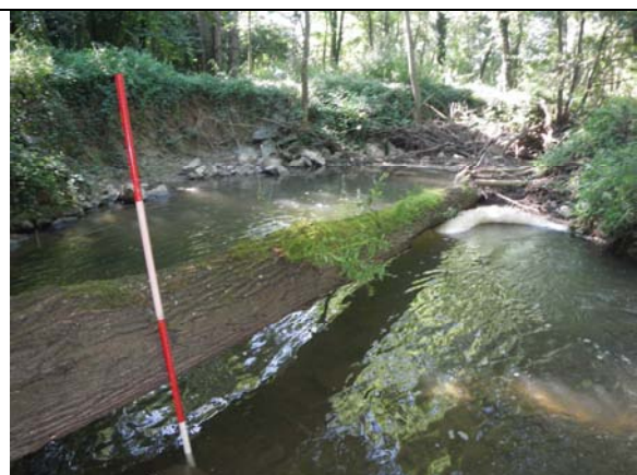
Photo 23 : zone mobile sur le tronçon PGR15a (enrochements détruits, encoche d'érosion et embâcle) (PGR15a)
