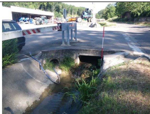
Photo 116 : La Bourbonne à l'amont de Lugny. Remblais et constructions en lit majeur, pont préfabriqué sous-dimensionné, seuil sous pont, buse d'arrivée d'eau pluviale, berges bétonnées... anéantissent totalement les fonctionnalités (en termes d'inondation et de qualité physique et physico-chimique notamment) naturelles du cours d'eau (BOU2)
