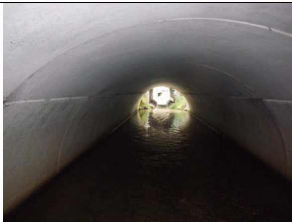
Photo 58 : Le passage sous la ligne TGV et sous la RN79. Le dépôt d'éléments graviers+sables, se forme sous le pont de la RN79, du fait de la sur largeur du « tunnel ».(DEN8)
