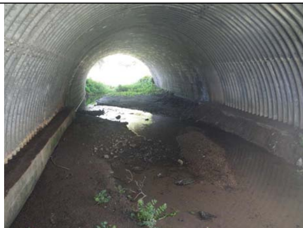
Photo 50 : Atterrissement important qui doit son origine au surdimensionnement du pont de la D17 (JOU2)
