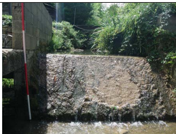
Photo 4 : Concrétions calcaires retirées sur le seuil de l'ancien moulin Tapin
