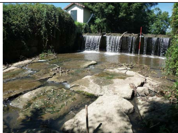
Photo 21 : vannage automatique du moulin de Narbonne (PGR12)
