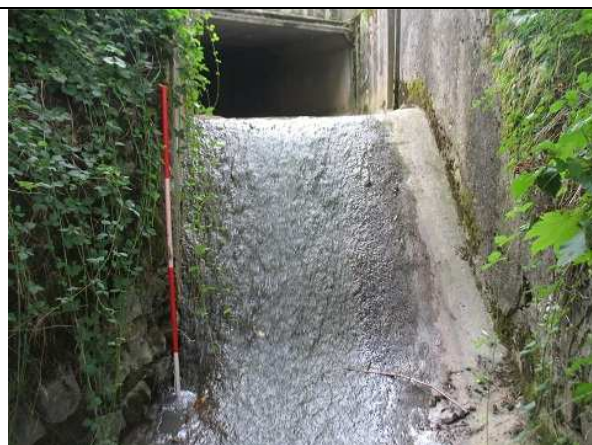
Photo 100 : Ouvrage infranchissable pour les espèces piscicoles au niveau d'Igé (PMO2b)
