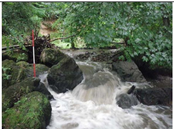
Photo 18 : Seuil détruit sur la Petite Grosne (PGR7a). Le talus en érosion est visible en arrière plan.
