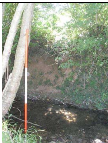
Photo 118 : encoche à proximité de la route D55, berges limono-argileuses de plus de 2m de haut le long de la route (BOU4)
