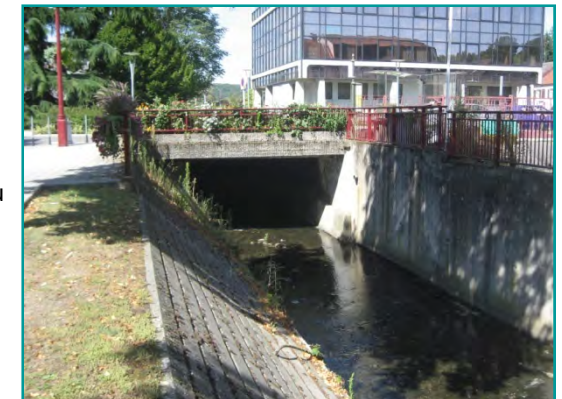
La Bisten dans la traversée de Creutzwald : couverture du ruisseau avec suppression du lit majeur Photo SOGREAH, 2009
