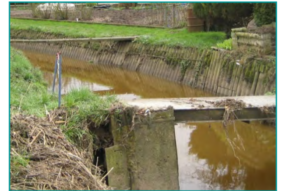
Berges de la Rosselle fortement dégradées Photo SOGREAH, 2008
