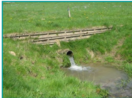
Suppression de la continuité biologique par un ouvrage sur le Muehlengraben Photo SOGREAH, 2009
