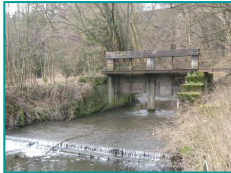
Ancien ouvrage sur la Rosselle permettant la mise en eau d'un canal (actuellement non utilisé) Photo SOGREAH, 2009
