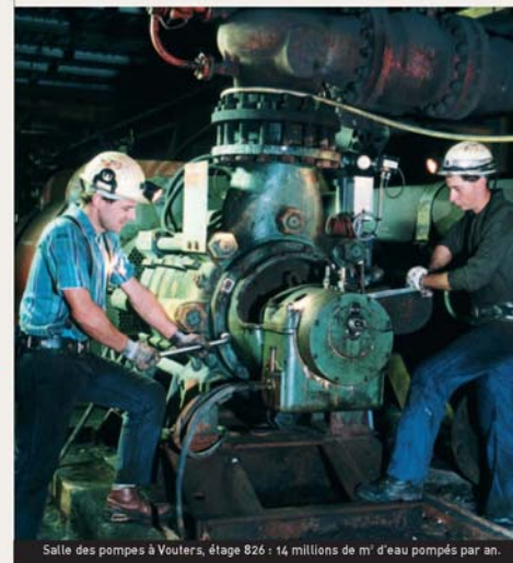
Salle des pompes à Vouters, étage 826 : 14 millions de m 3 d'eau pompés par an.
