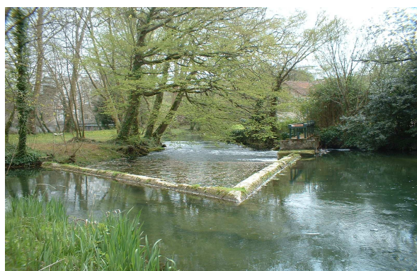
Déversoir en « V » (réparti les eaux 1/3-2/3 environ)
