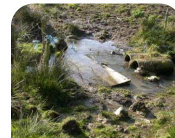
Avant travaux Berges dégradées
