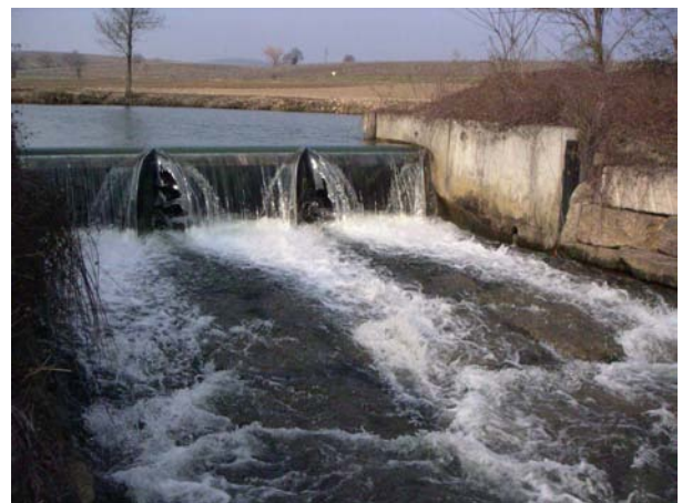
Figure 16 - clapet automatique de Prissé (Narbonne)
