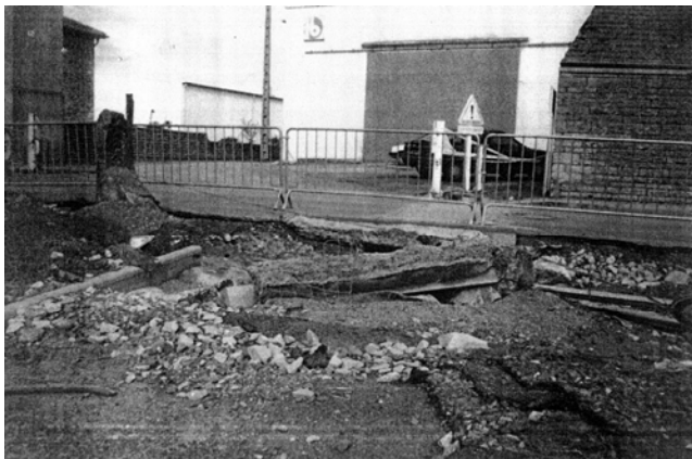
Figure 12 - photo de routes détruites en 1983
