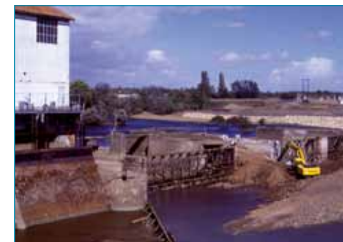
Le barrage de Maisons rouges sur la Vienne pendant la déconstruction en 1998 (37) - © Josselin De Lespinay
