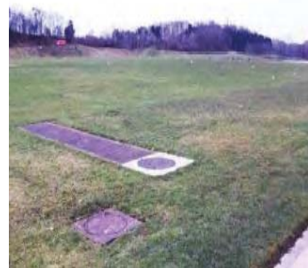
Regards de visites sur la Vieille Mer canalisée au niveau du Parc G. Valbon
